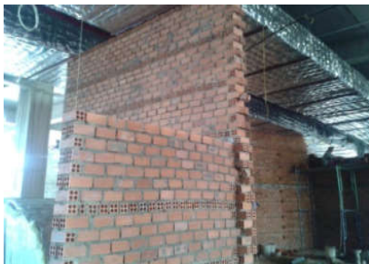
8. TƯỜNG XÂY KHÔNG ĐẸ MỎ CHỜ
